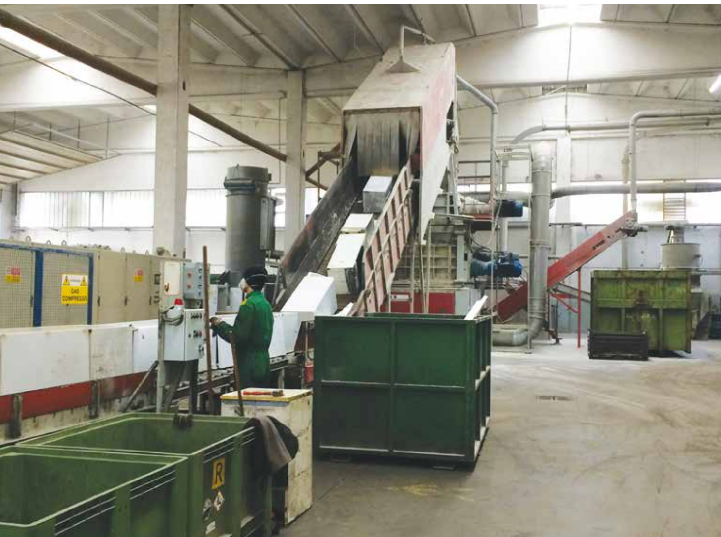
Foto 5.08 Impianto di riciclaggio Fonte MATTM
